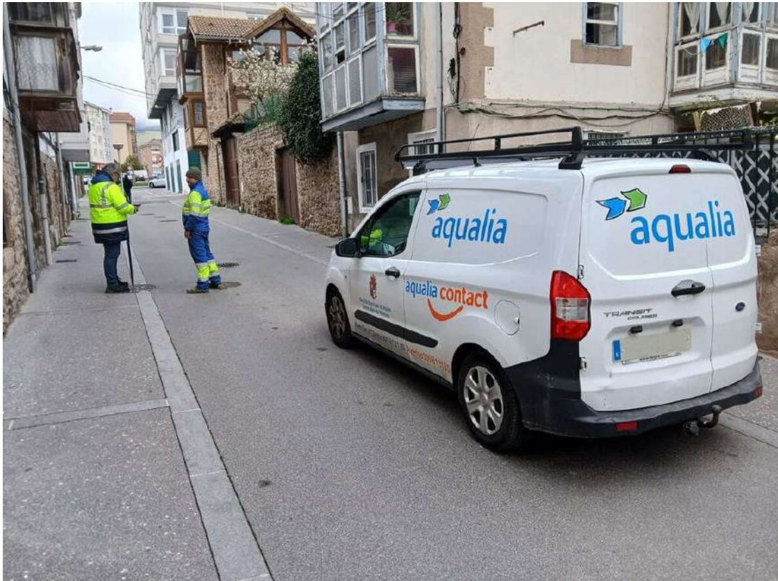
Una avería provoca problemas en el abastecimiento
